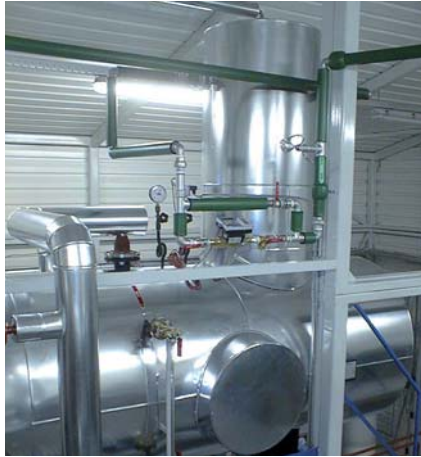
Bild 52: Entgaser der Niederdruckentgasung auf einem Speisewasserbehälter
