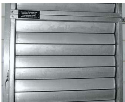
Bild 77: Zuluftöffnung des Aufstellraumes mit Schalldämpfer
