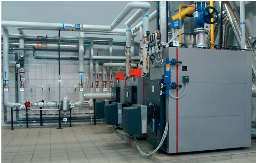
Bild 15: Anlage mit drei Vitoplex – ein Niederdruckdampferzeuger und zwei Warmwassererzeuger
