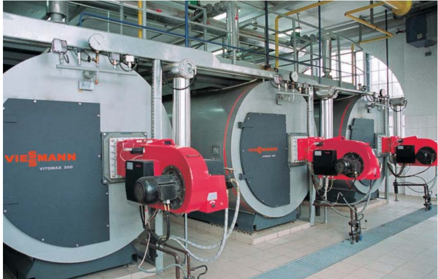
Bild 71: Dampfversorgung im Krankenhaus AMH Chorzow Polen – drei Hochdruck-Dampferzeuger Vitomax 200 HS mit 2,4 t/h (8 bar) versorgen die Heizung, Wäscherei und Sterilisation mit Dampf
